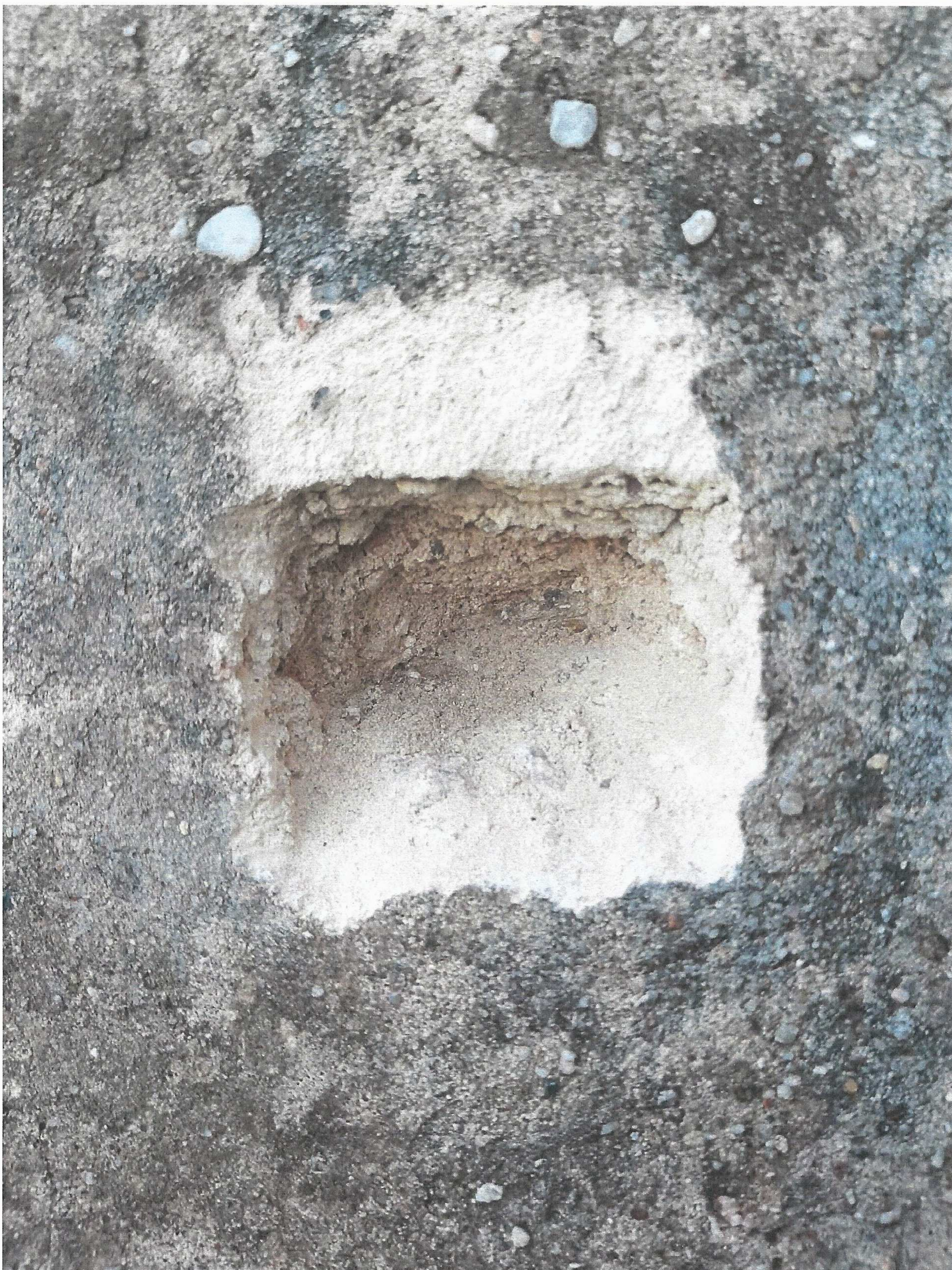
Fot.4. Kościół p.w. Świętej Jadwigi Śląskiej w Gilowie ; fragmenty elewacji zachodniej zakrystii - odkrywka nr II. . Czytelne silne wypłukanie powierzchni lica ujawniające gruboziarnistą strukturę tynku . Odkrywka pokazuje znaczną grubość tynku z dużą zawartością wapna ; Całość silnie zabrudzona mechanicznie [ spetryfikowane ] lokalnie porażona biologicznie.
