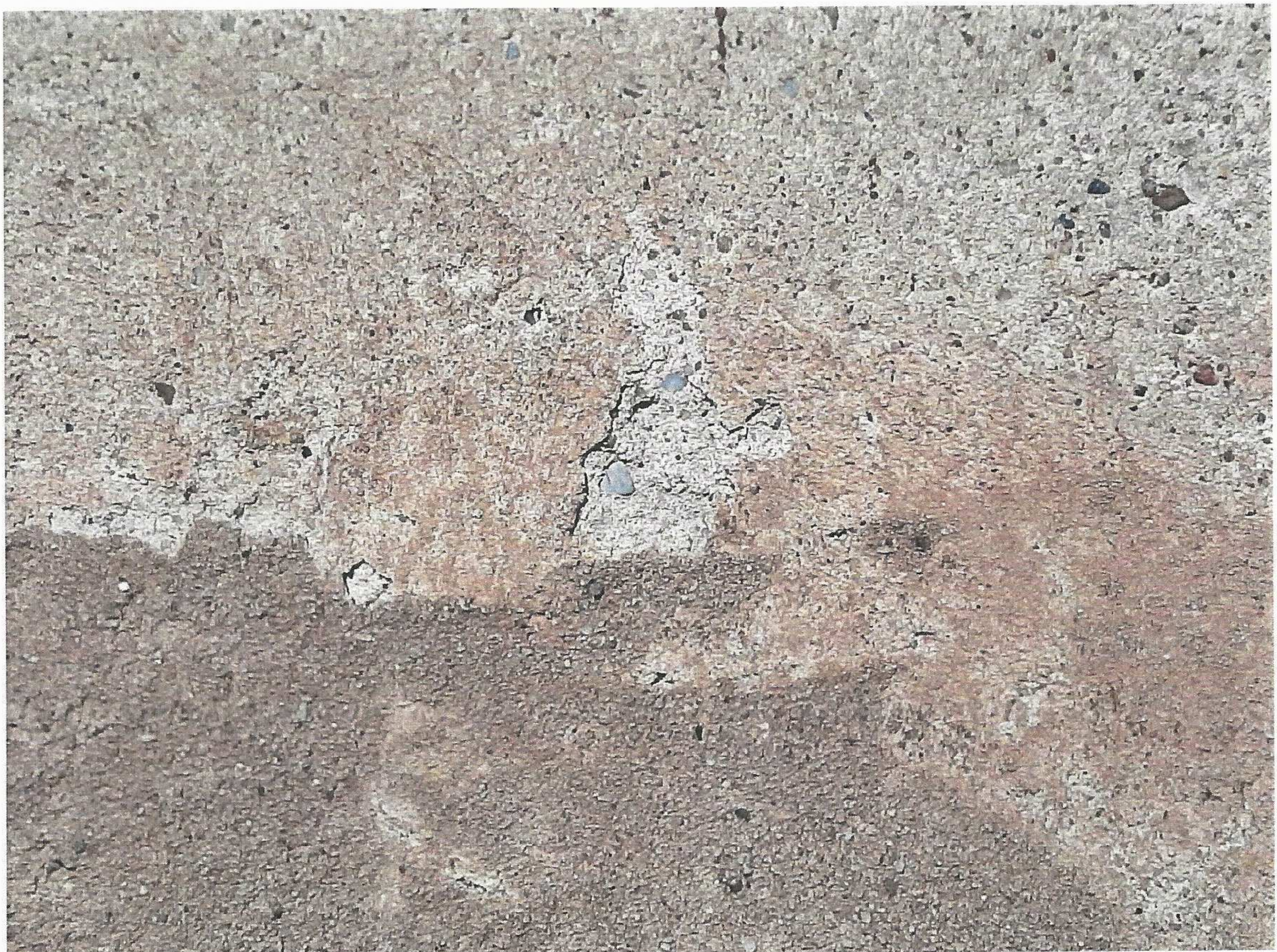
Fot. 24 i 25 . Kościół p.w. Świętej Jadwigi Śląskiej w Gilowie ; fragment pasa cokołowego elewacji wschodnich prezbiterium i zakrystii; widoczne znaczne wypłukanie malatury oraz odspojenia i spękania tynku wraz z tynkami naprawczymi o zróżnicowanym składzie.
