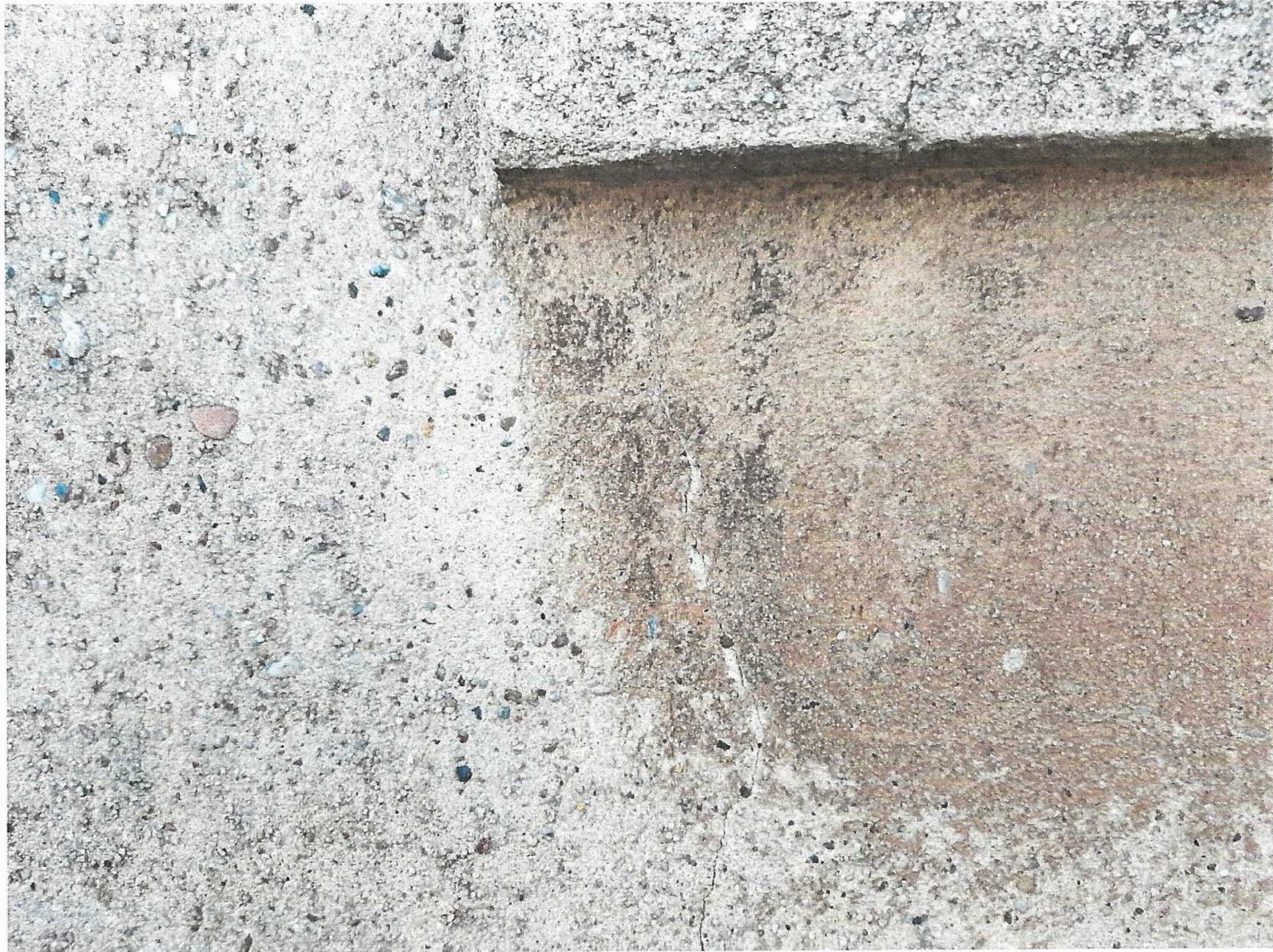
Fot.11. Kościół p.w. Świętej Jadwigi Śląskiej w Gilowie ; fragmenty elewacji zachodniej zakrystii ; widoczne relikty malatury z lokalizacji na fot.10.
