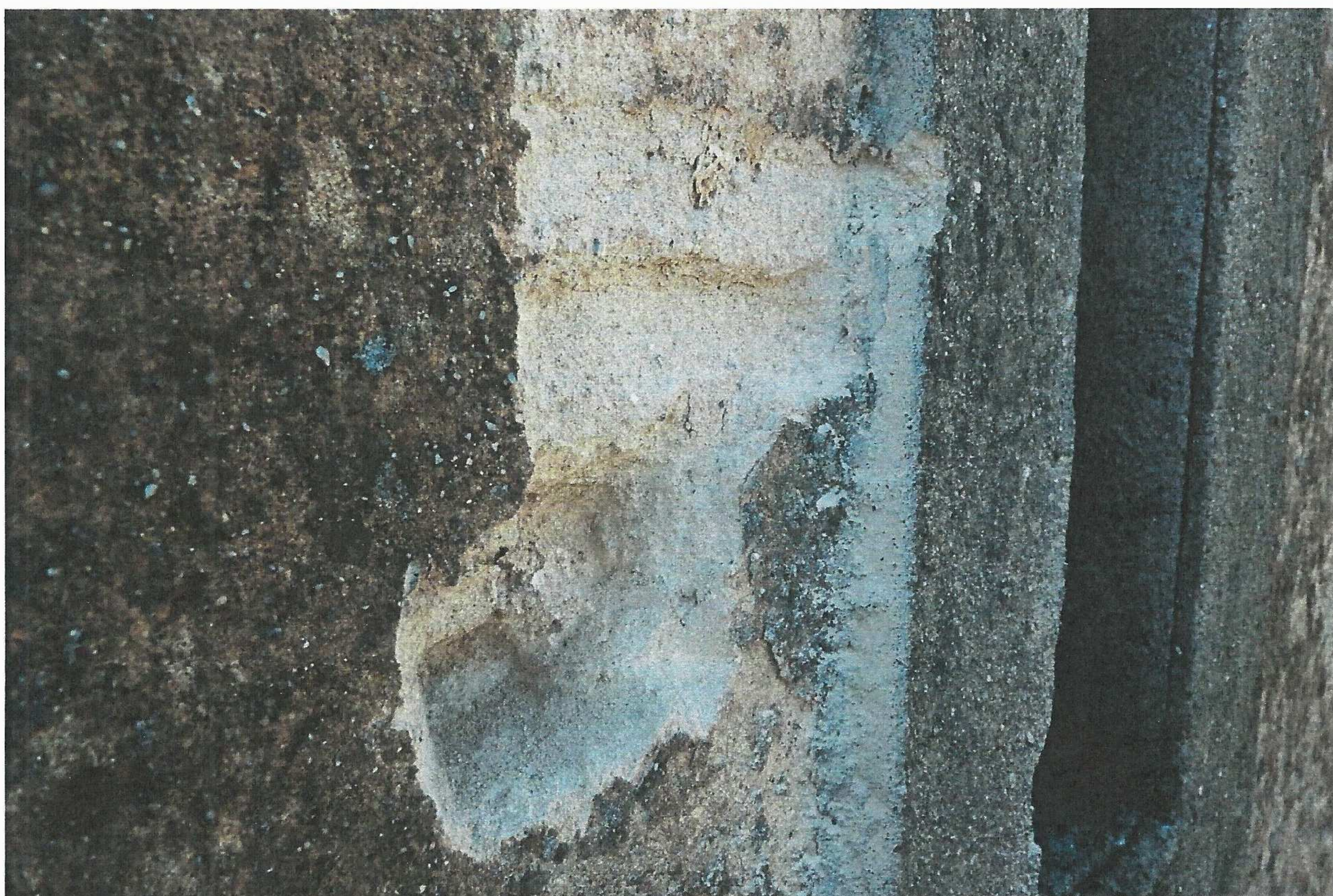
Fot.30 i 31 .. Kościół p.w. Świętej Jadwigi Śląskiej w Gilowie ; odkrywki przy otworach okiennych wieży [ strona wschodnia i północna ] widoczna znaczna grubość tynku wapiennego oraz silne zabrudzenie powierzchniowe [ spetryfikowane ] ; ślady porażenia biologicznego.
