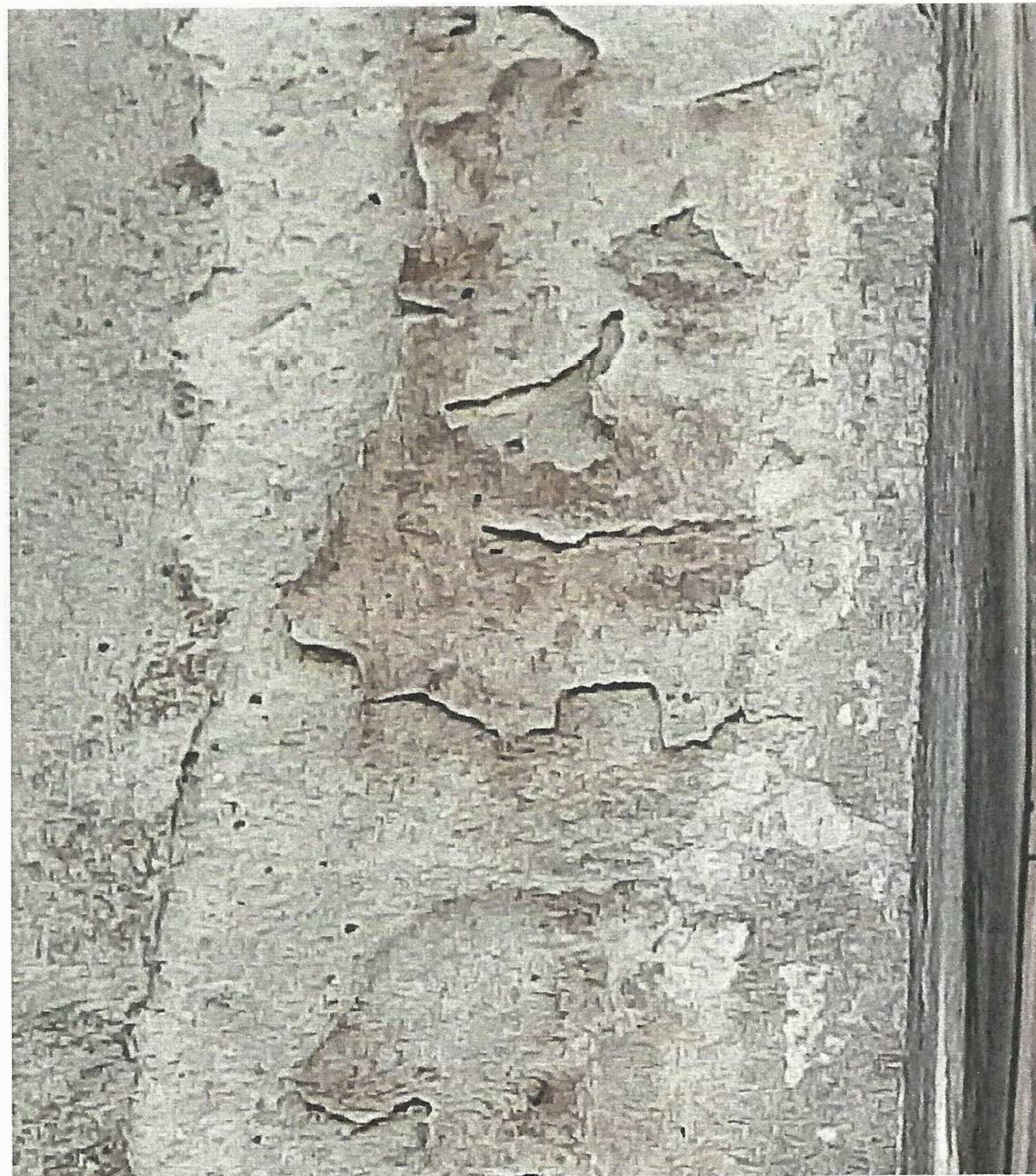
Fot.8 i 9. Kościół p.w. Świętej Jadwigi Śląskiej w Gilowie ; fragmenty elewacji zachodniej zakrystii wzdłuż pd-zach naroża .Widoczne odspojenia i rozwarstwienia tynku jako skutek długotrwałego zalewania , co widoczne jest także w postaci ciemnych zacieków na profilowanym gzymsie . Warstwa malatury w większości wymyta.
