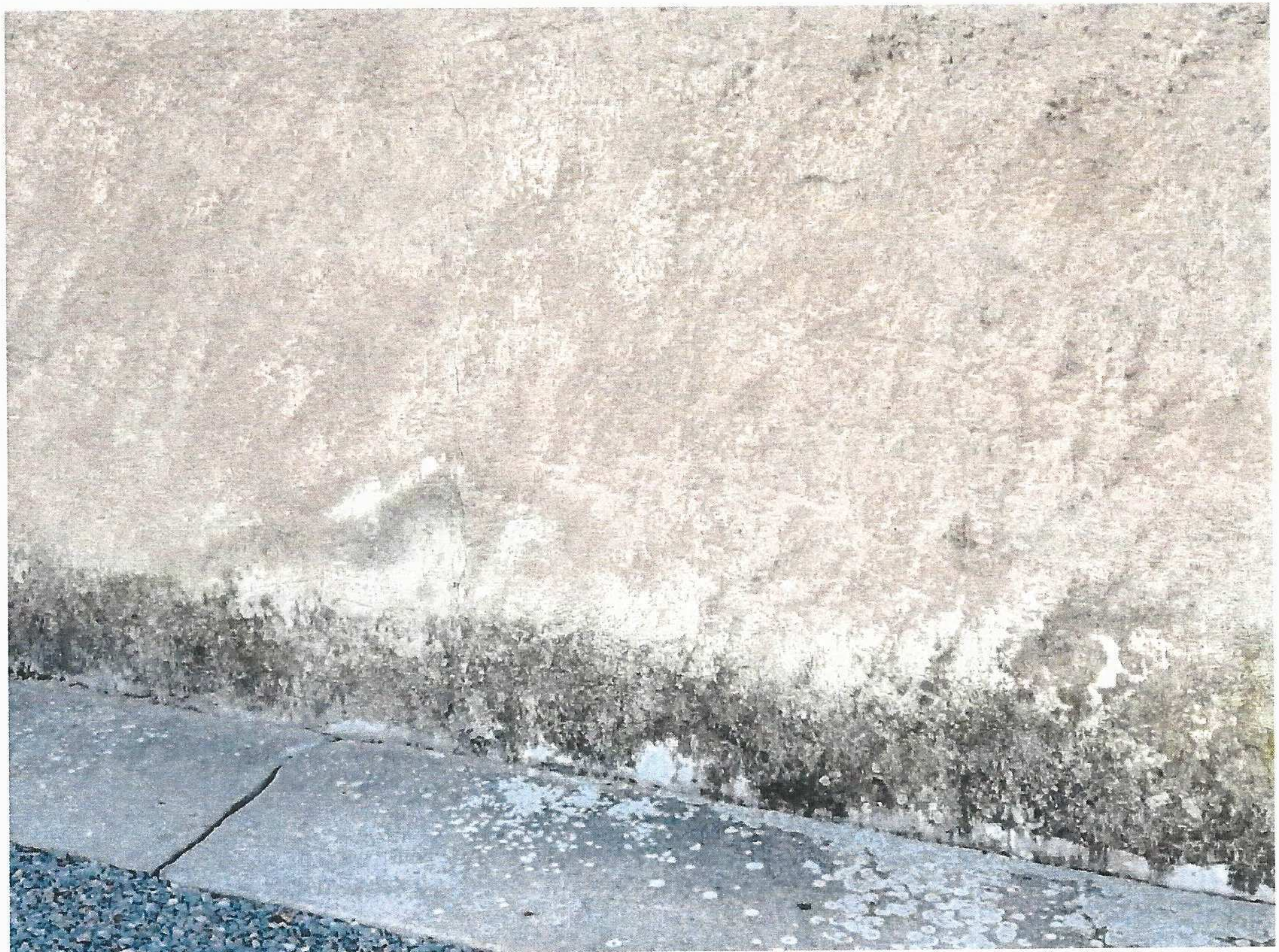
Fot. 34 i 35 . Kościół p.w. Świętej Jadwigi Śląskiej w Gilowie ; fragmenty elewacji zachodniej wieży. Widoczny fakturalny sposób nakładania tynku. W odkrywce układ oraz grubość tynku taki jak na pozostałych elewacjach kościoła. Dolne partie silnie zbrudzone ze śladami porażenia biologicznego.
