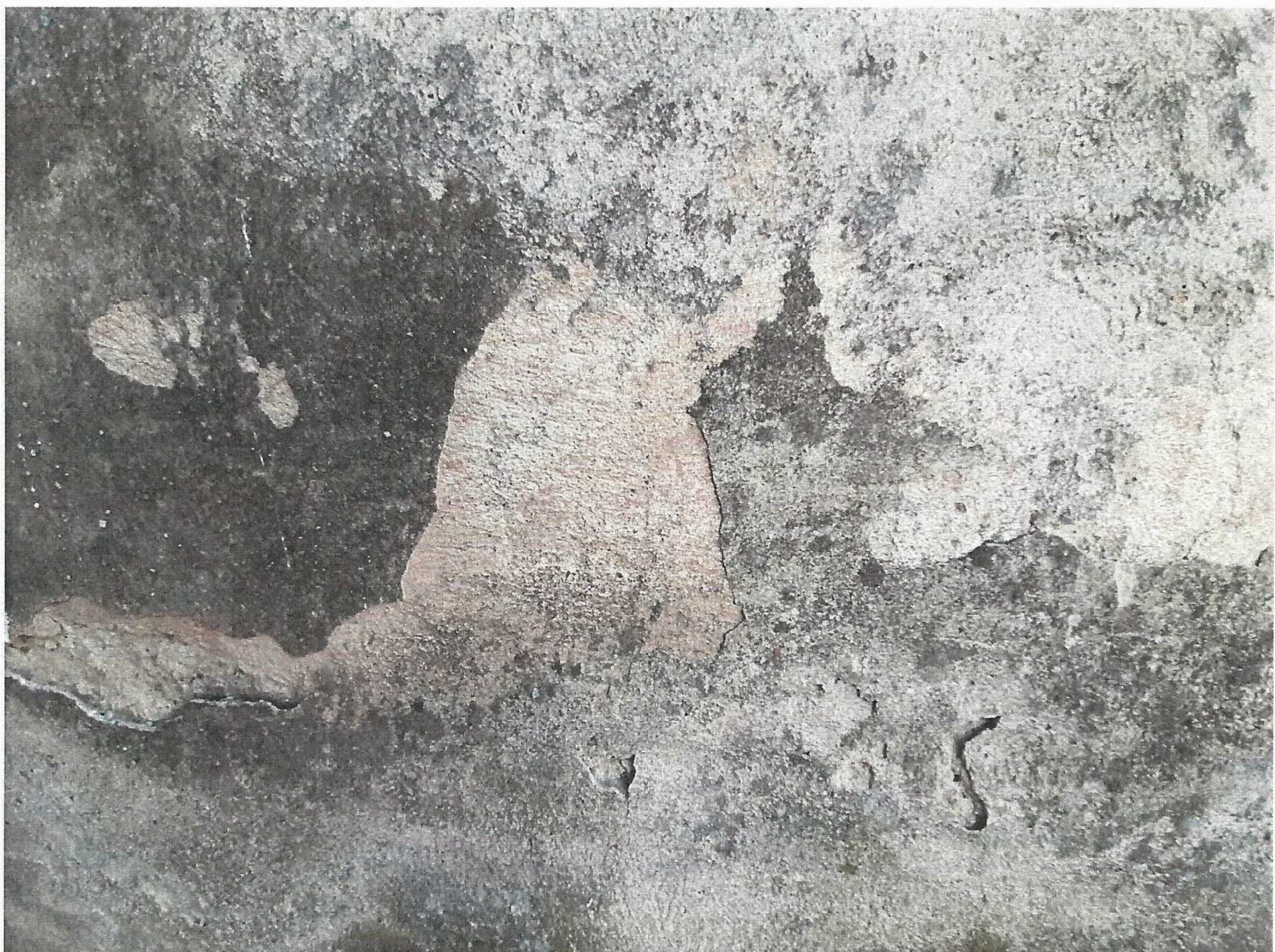
Fot.5 i 6 . Kościół p.w. Świętej Jadwigi Śląskiej w Gilowie ; fragmenty partii cokołowych elewacji zachodniej zakrystii. Widoczne przetynkowania oraz odspojenia wtórnych warstw tynczków i zacierek o różnym składzie także z dużą zawartością cementu. Całość silnie zabrudzona mechanicznie lokalnie porażona biologicznie [ rozproszone i skupione ciemne plamy ].
