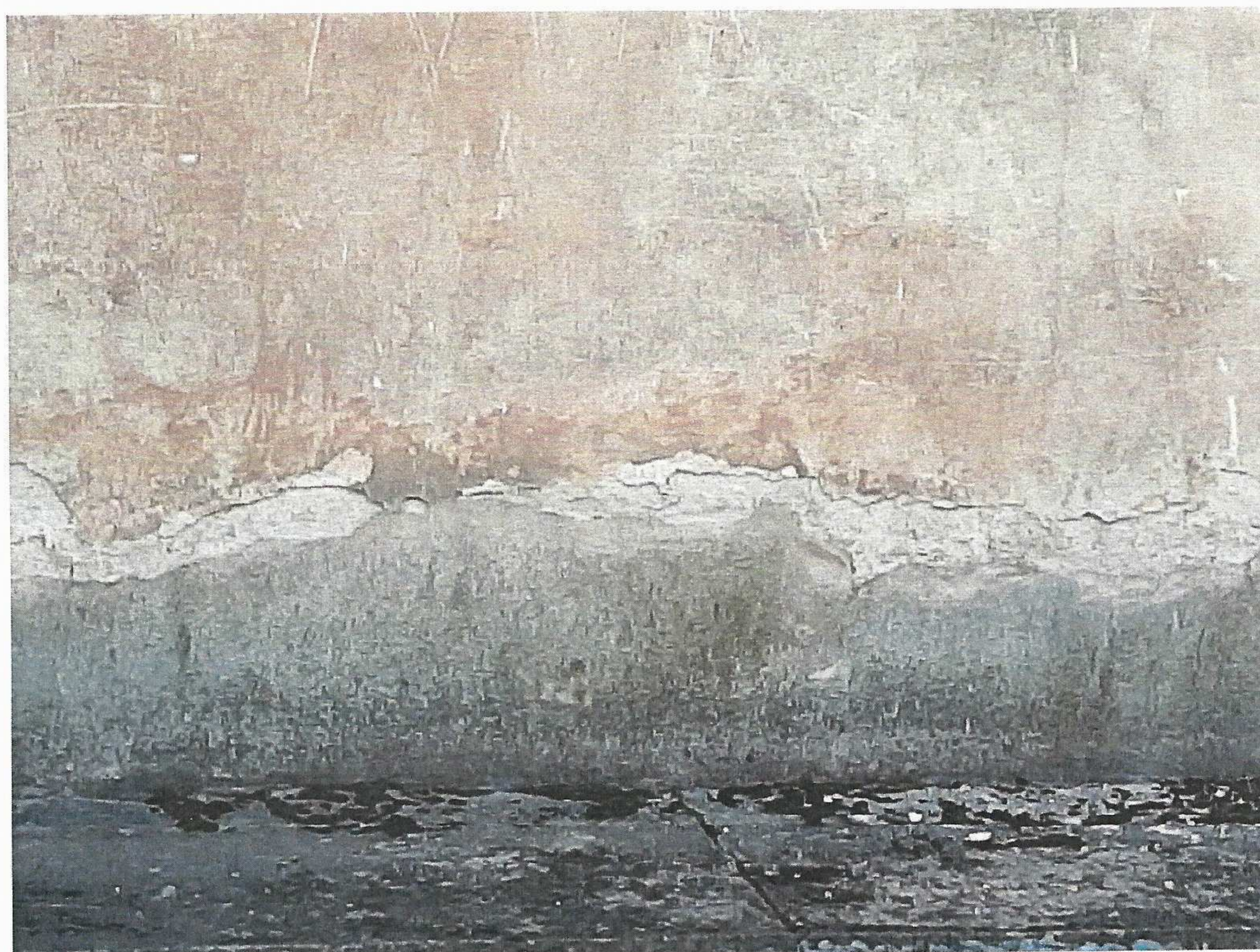
Fot. 15 i 16 . Kościół p.w. Świętej Jadwigi Śląskiej w Gilowie ; widok ogólny elewacji północnej nawy oraz fragmenty wtórnie przetynkowanej partii cokołowej ; na granicy z tynkiem wapiennym - ubytki. Widoczne znaczne wymycie malatury .
