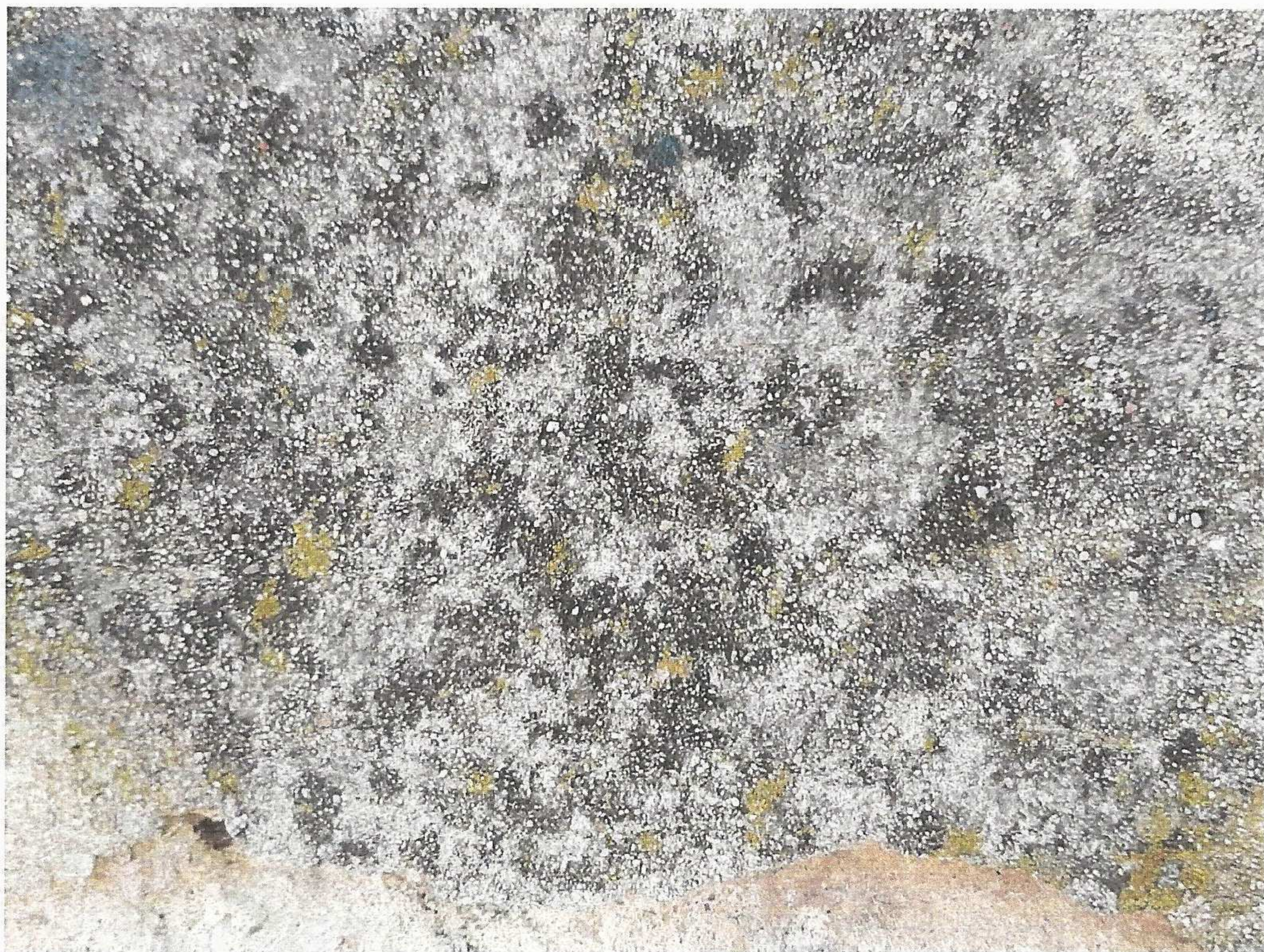
Fot.13 i 14 Kościół p.w. Świętej Jadwigi Śląskiej w Gilowie ; fragmenty partii cokołowych elewacji zachodniej zakrystii. Widoczne przetynkowania . Całość silnie zabrudzona mechanicznie lokalnie porażona biologicznie [ czarne i zielono-brązowe plamy ].
