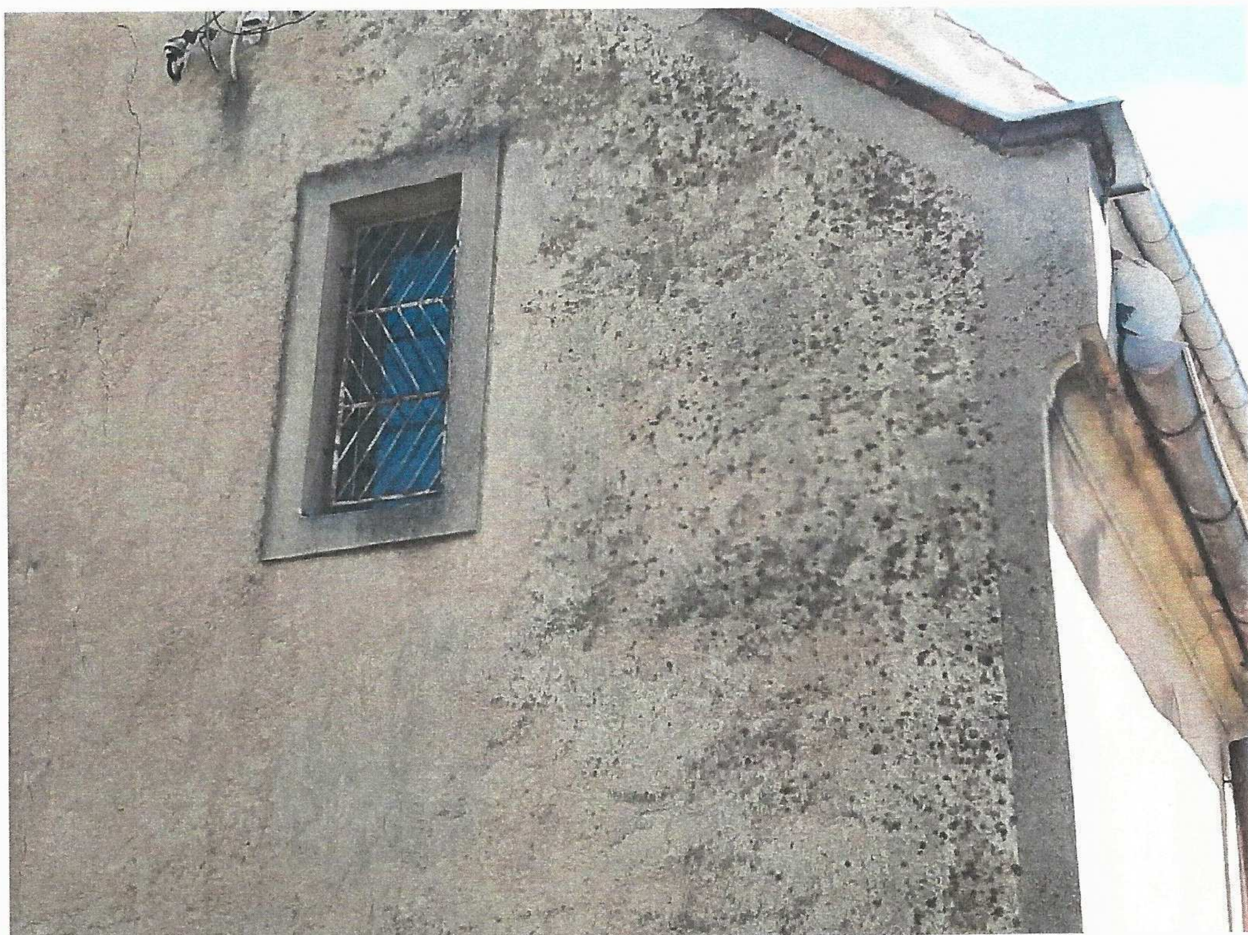
Fot. 32 i 33 .. Kościół p.w. Świętej Jadwigi Śląskiej w Gilowie ; fragmenty elewacji zachodnich wieży .Widoczne spękania i odspojenia tynków , znaczne zabrudzenia mechaniczne oraz lokalne porażenie biologiczne [ zawilgocenie ]
