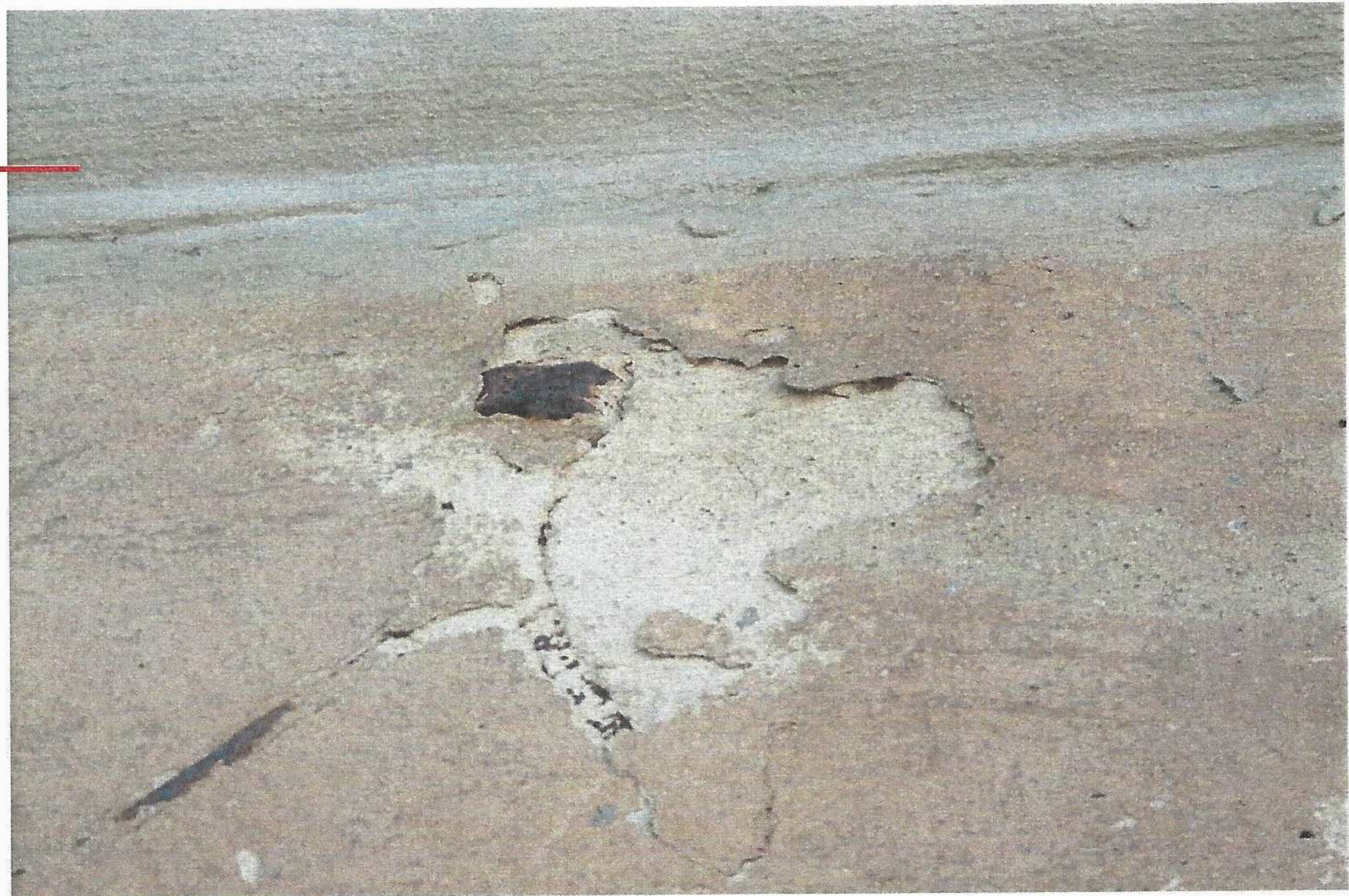
Fot. 18 . Kościół p.w. Świętej Jadwigi Śląskiej w Gilowie ; odkrywka nr III z widocznymi odspojeniami wierzchniej warstwy tynku wraz z malaturą jako wynik wcześniejszego zawilgocenia ; powyżej odkrywki fragment nowego gzymsu.
