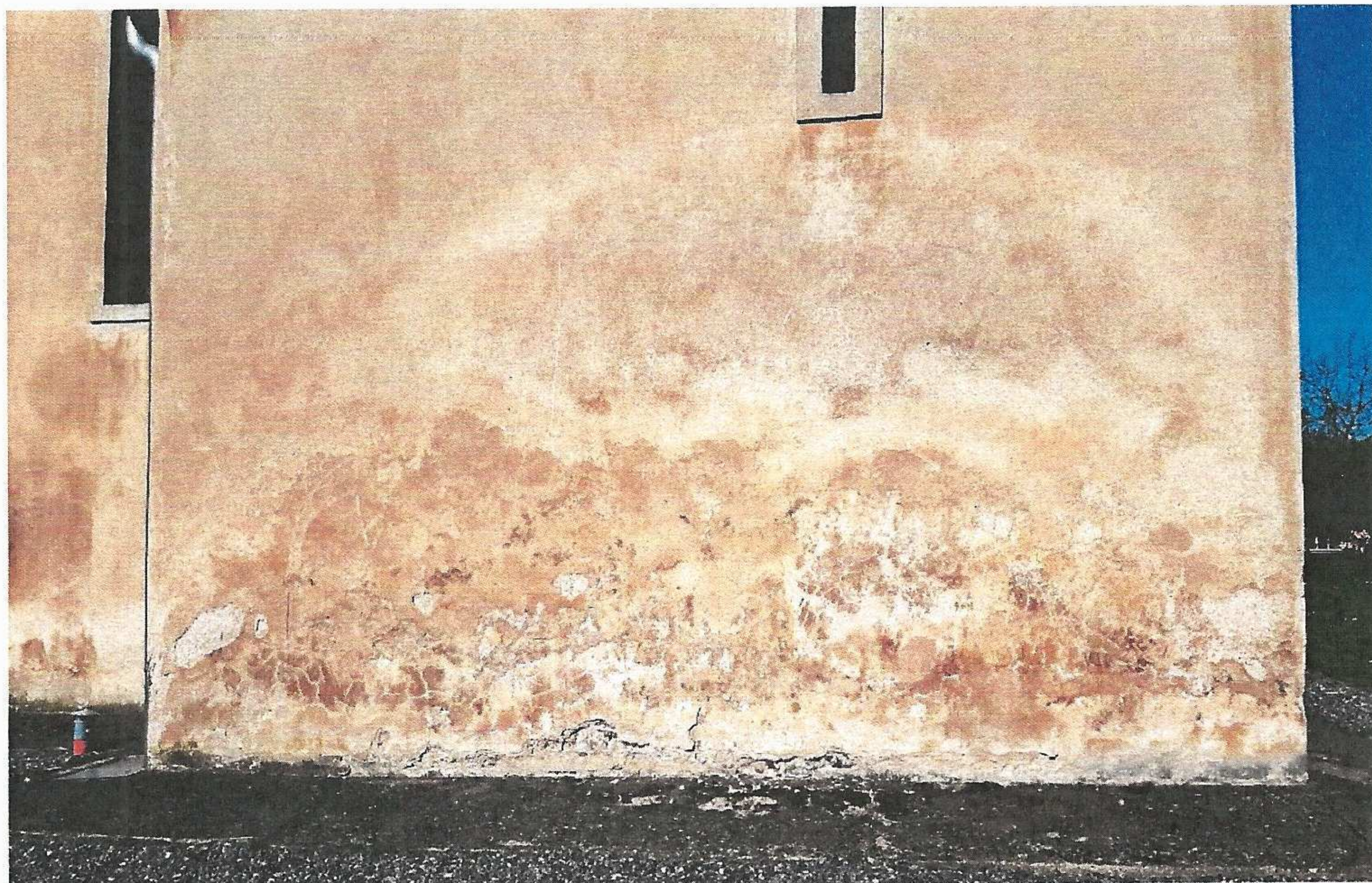
Fot. 21 i 22. Kościół p.w. Świętej Jadwigi Śląskiej w Gilowie ; fragmenty elewacji wschodnich prezbiterium i zakrystii; widoczne znaczne wypłukanie malatury oraz odspojenia i przetynkowania w wysokim pasie cokołowym [ skutki wcześniejszego znacznego zawilgocenia ] .
